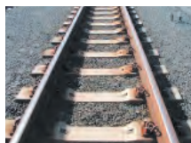
弾性バラスト直結軌道
