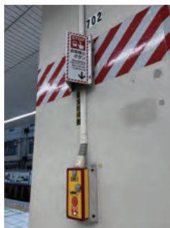
非常停止ボタン
