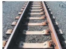
弾性バラスト直結軌道
