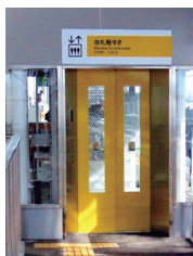
エレベーター(武蔵砂川駅)
