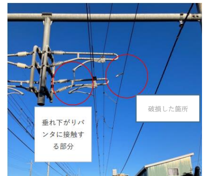
(参考) 破損した架線金具の一部
