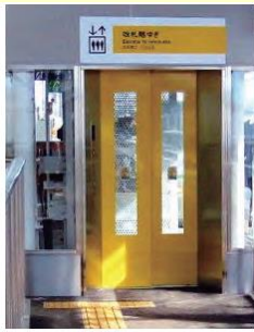
エレベーター(武蔵砂川駅)
