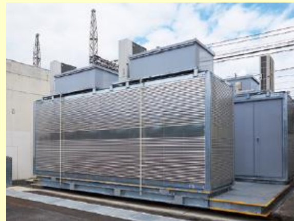
回生電力貯蔵装置(田無変電所)
