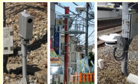
踏切支障検知装置
